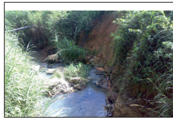
Deslizamentos são comuns no Ribeirão da Serra
