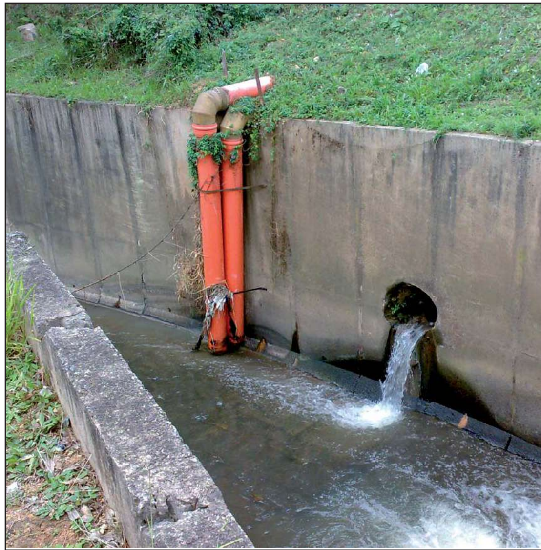
Interceptor lançou diretamente no ribeirão milhares de toneladas de esgoto após deslizamento atrás da 25ª DRPC em 2008
