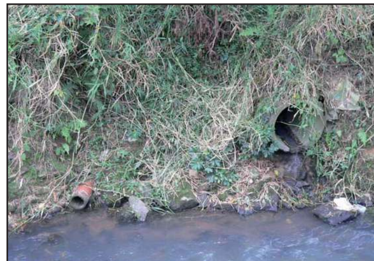
Esgoto clandestino é lançado em diversos pontos do ribeirão
