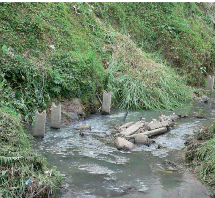
No bairro Augusto de Almeida, a rede que coletava o esgoto clandestino foi destruída e assim continua
