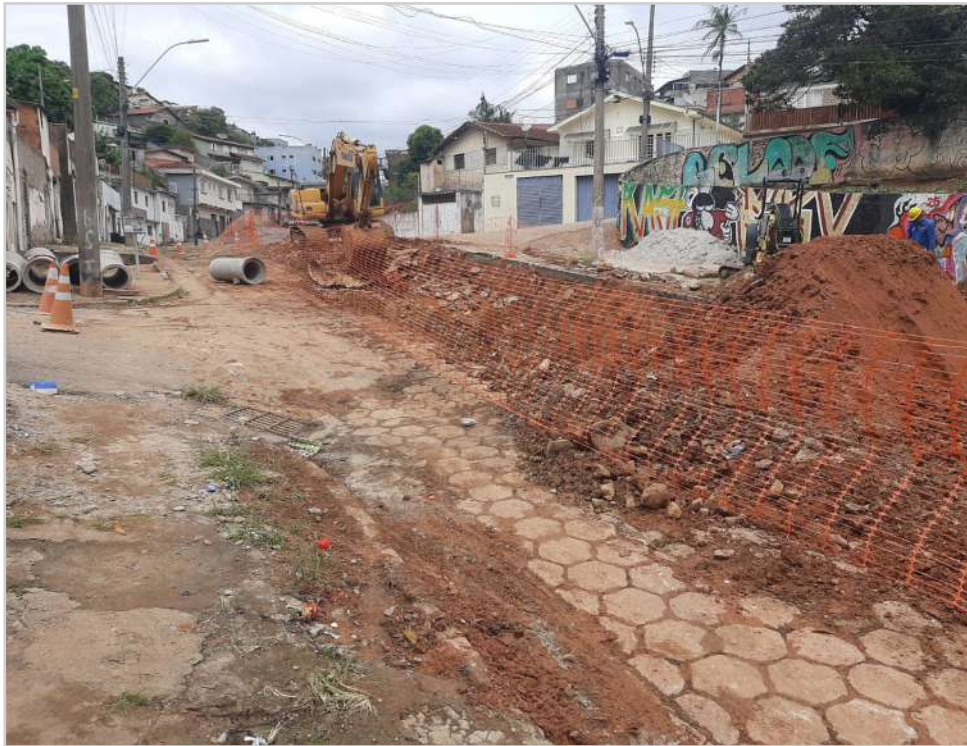
As chuvas tornaram pior a situação que já era ruim na Av. Eng. Ubirajara de Machado de Moraes
